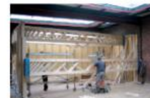
Une « boîte » composée de modules de murs à ossature bois de 140 cm x 60 cm soutient les poutres et s'insère dans l'enveloppe de briques existante.
